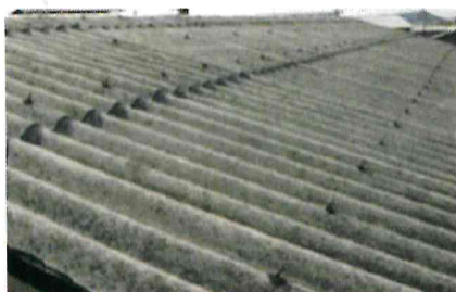
アスベスト含有スレート（波板）
