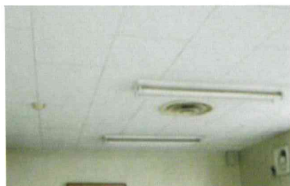
アスベスト含有化粧ボード（天井）
