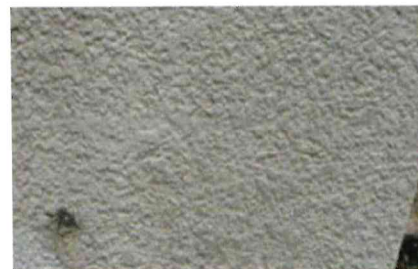
アスベスト含有仕上塗材（外壁の例）
